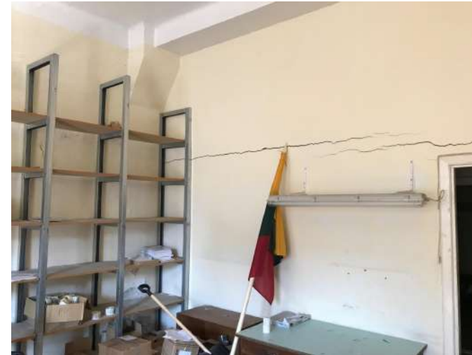
Viduje pirmo aukšto pertvarinėse sienose matomi įtrūkiai. Būtina įvertinti konstrukcijų būklę ir autentiškumą.
