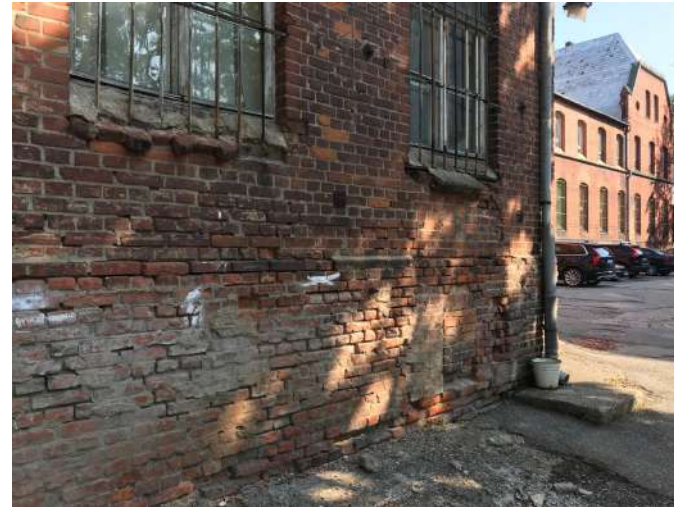
Buvusio komutatoriaus pastato fasadų būklė bloga. Reikalingas plytų mūro remontas ir restauravimas.
