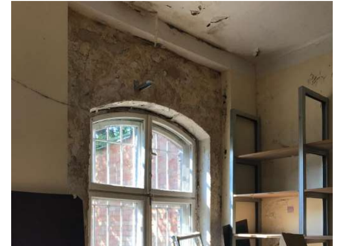
PV pastato kampe sienos pažeistos drėgmės.
