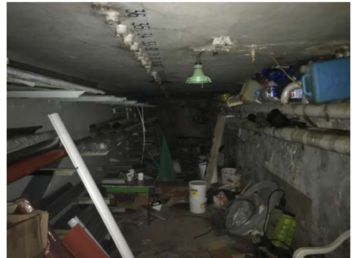
Rūsio būklė pakankamai gera, tačiau patalpoje jaučiama drėgmė. Reikalinga įvertinti paveldosauginę vertę ir galimybę plėsti rūsio erdves.
